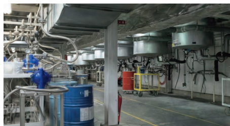
工場設備・配管などの現場管理に活用(当社 三重工場)
